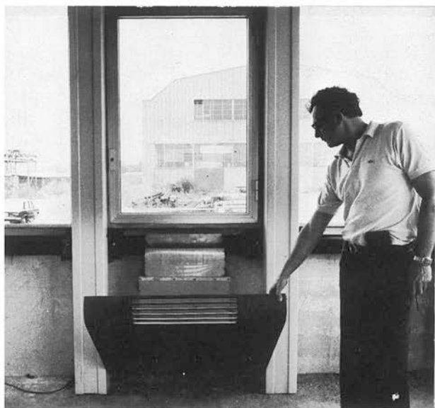
La copertura del condizionatore.
